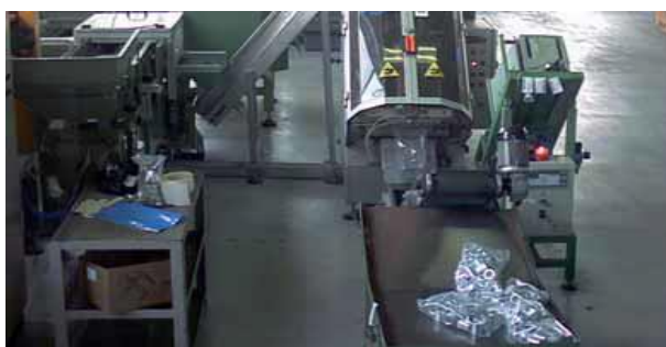
Impianto di confezionamento di minuterie metalliche. Packing system for nuts and bolts.
