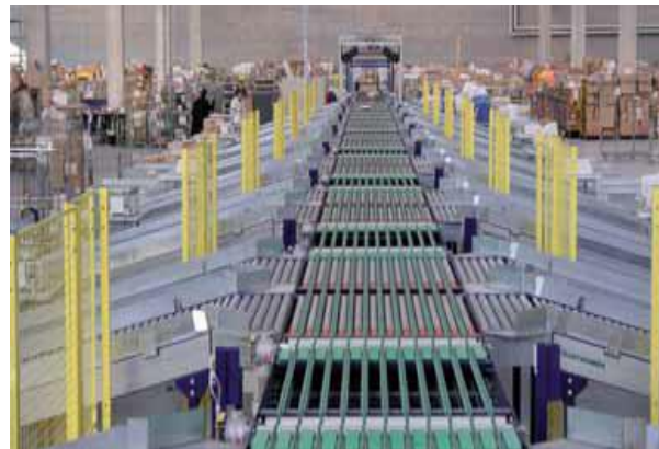
Impianto automatico di handling and sorting predisposto per l'identificazione dei colli, la rilevazione del peso e del volume e la destinazione in 32 baie di scarico.
